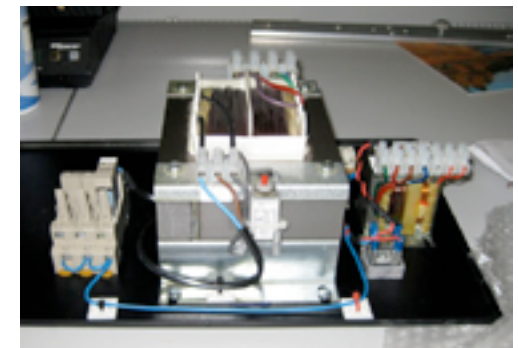
Muuntajat ja relekatat paikallaan. Anodimuuntaja on jostain syystä varustettu valmistajan toimesta peräti 10A automaattisulakkeella.
